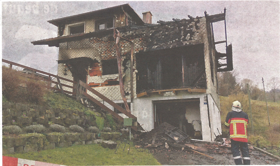
La villa mitoyenne a été entièrement détruite par les flammes, faisant une victime. -S. WESPI
